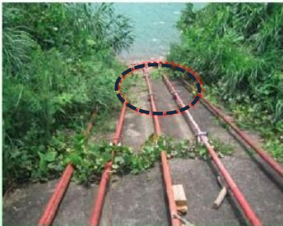
⑤ 斜樋の破損(スピンドル挫屈)
