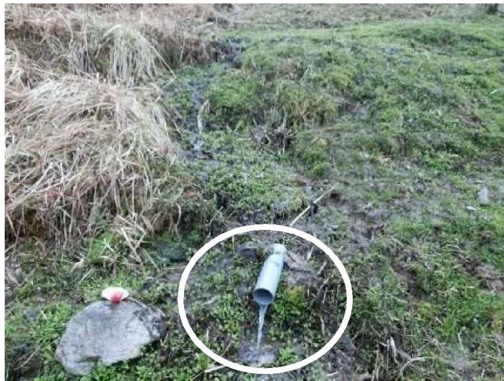
後法 漏水(遠景)
