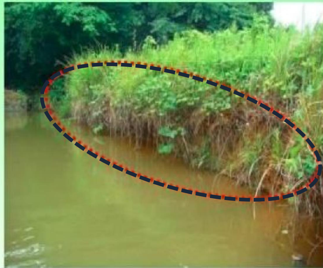
②堤体の著しい浸食
