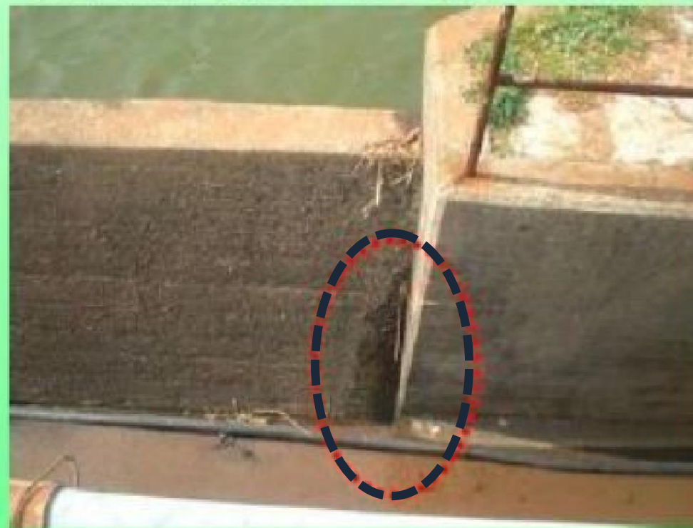
⑧ 継目、亀裂からの漏水(水路壁の変色)
