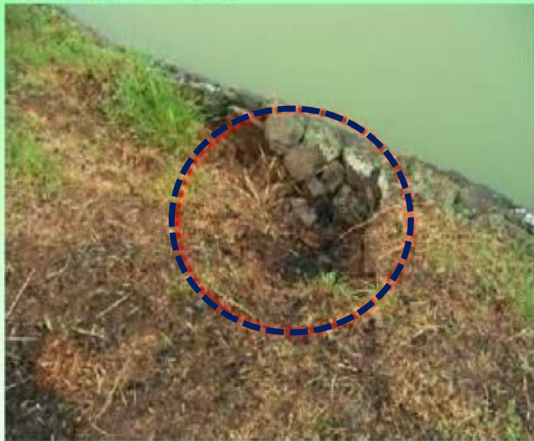
①堤体の陥没
