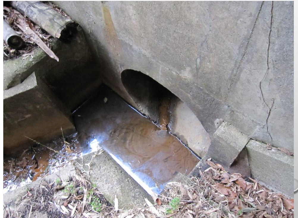
底樋管の破損による閉塞
