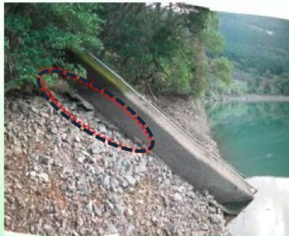
⑥ 斜樋底部の陥没
