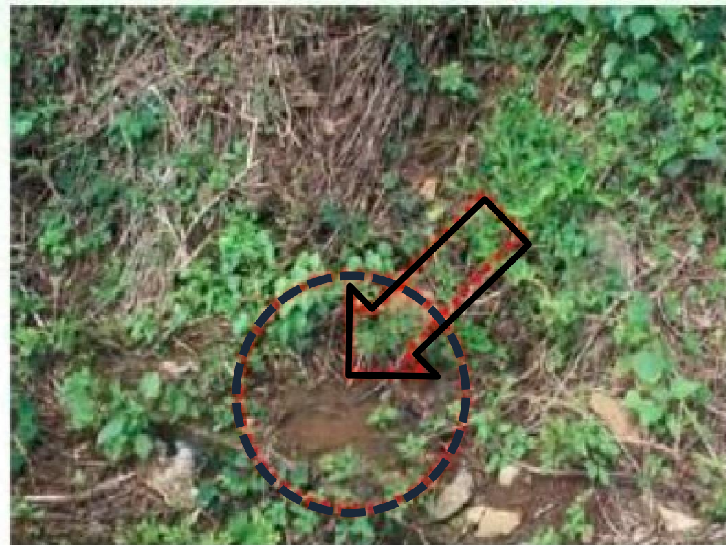
④染みだしやパイピングによる漏水
