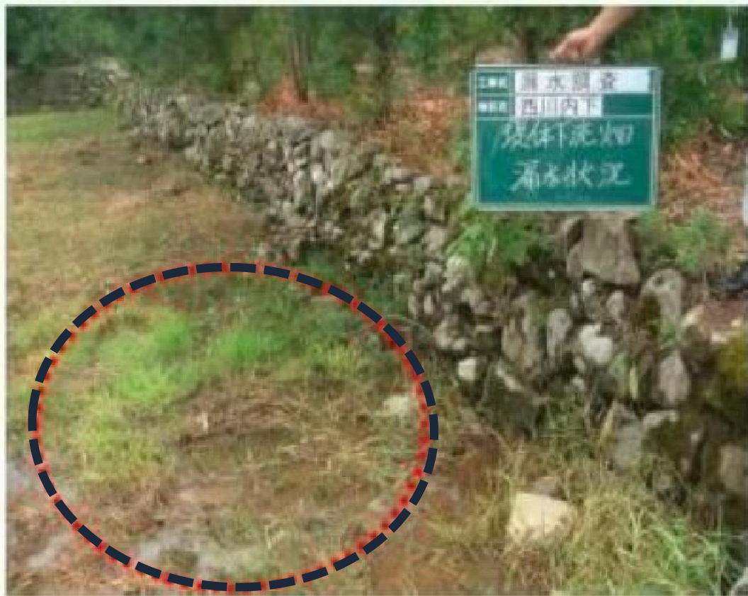
③腰石垣のはらみ出しや漏水
