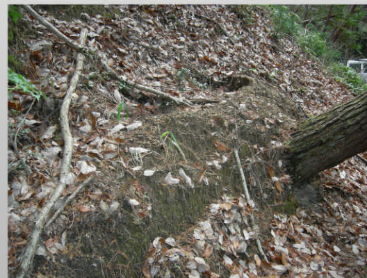
堤体土を大きくエグっている
