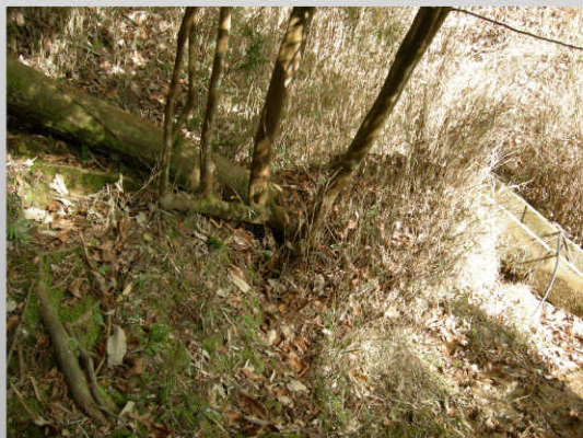
木の根部分から、漏水が発生しておりました
