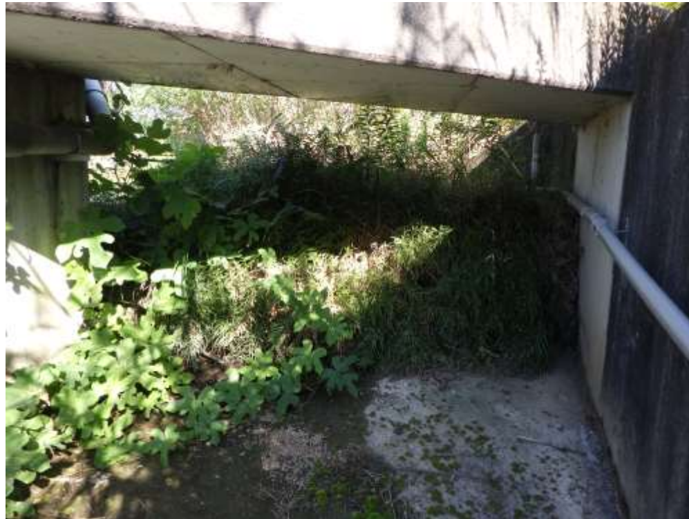
余水吐を土嚢で閉塞 H \approx 1.0\text{m} (R5点検調査より土嚢で閉塞事例)
