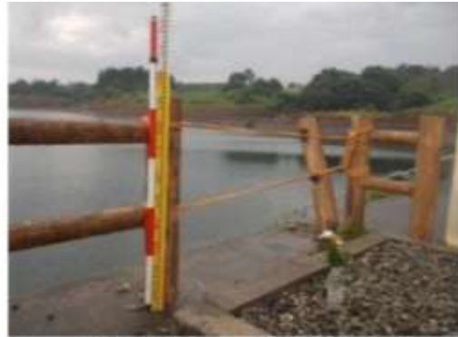
破損箇所にはロープ等で進入防止措置を講じ、速やかに補修
