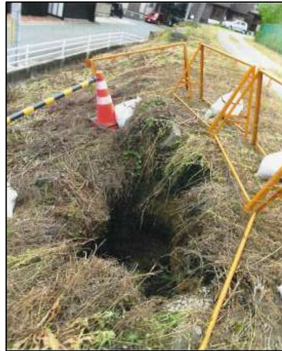
R5 豪雨災害によるため池堤体の被災事例 (外法の陥没現象)
