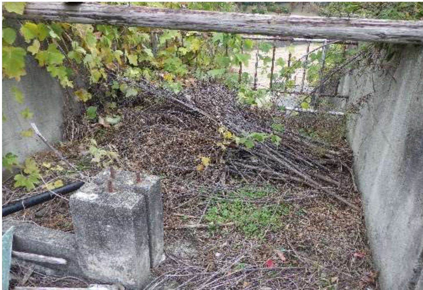
ゴミによる通水阻害
