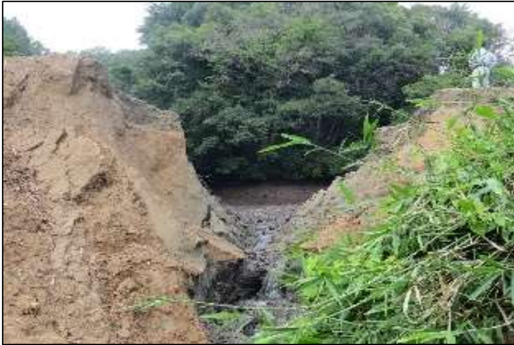
H30年7月豪雨(西日本豪雨)による ため池堤体の決壊事例
