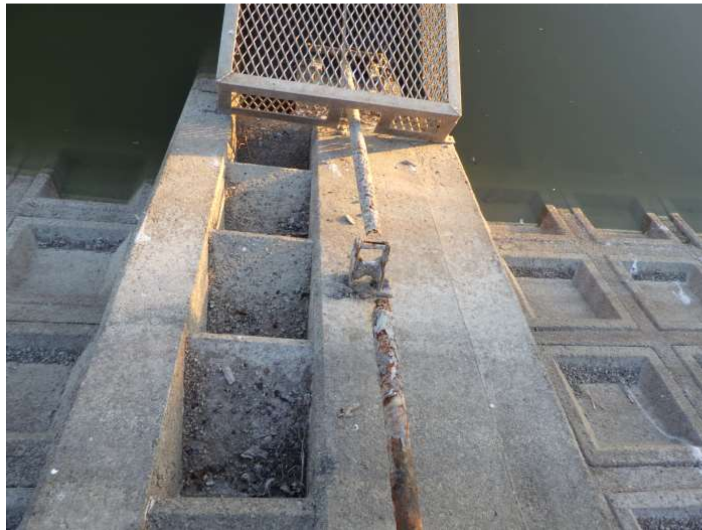
スピンドルの座屈や破断 (R5点検調査より破断事例)
