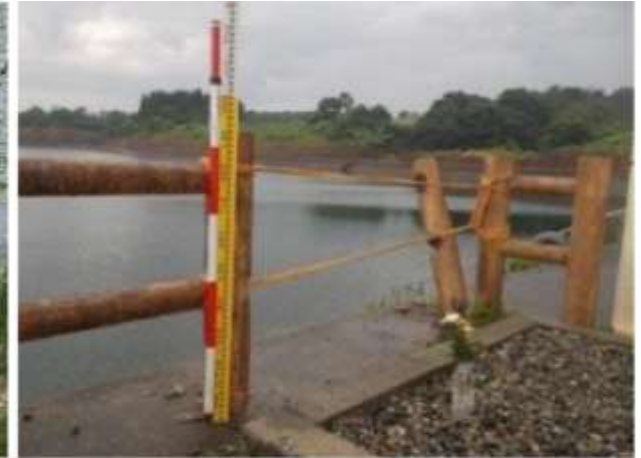
破損箇所にロープ等で進入防止措置を講じ、速やかに補修
