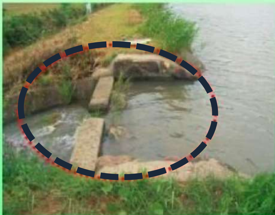
⑦ 余水吐の堰上げ
