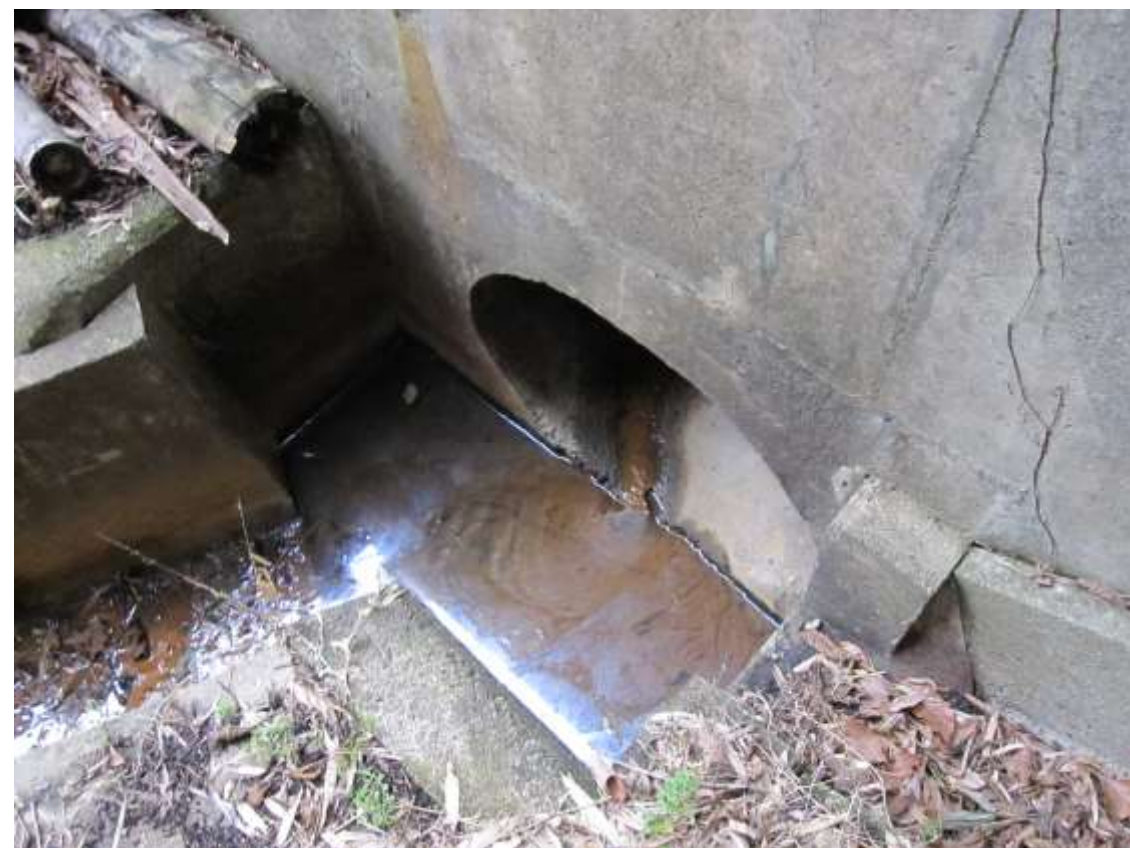
底樋管の破損によりゲートを閉めても水が出ていたり、通水障害が生じたりしている事例
