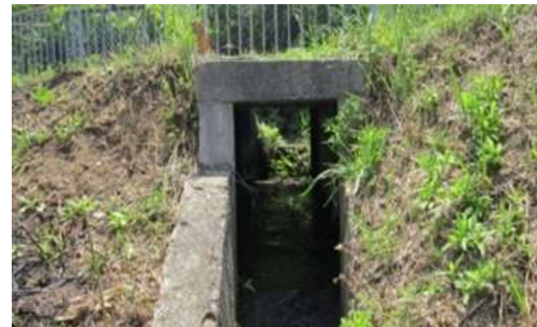
余水吐の断面が小さい
