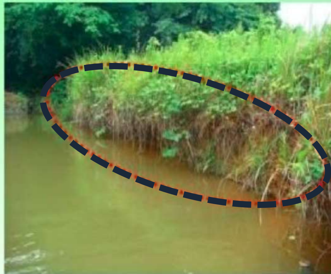
② 堤体の著しい浸食
