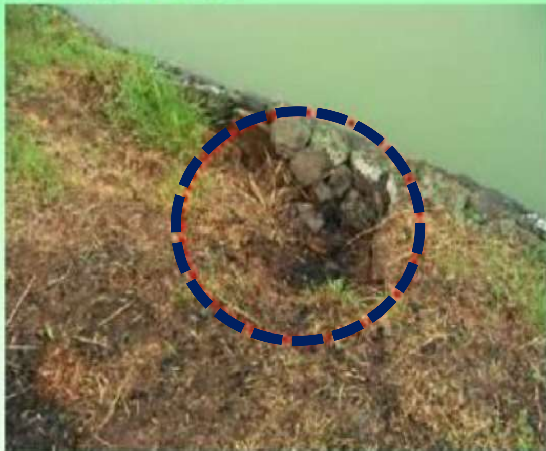
① 堤体の陥没
