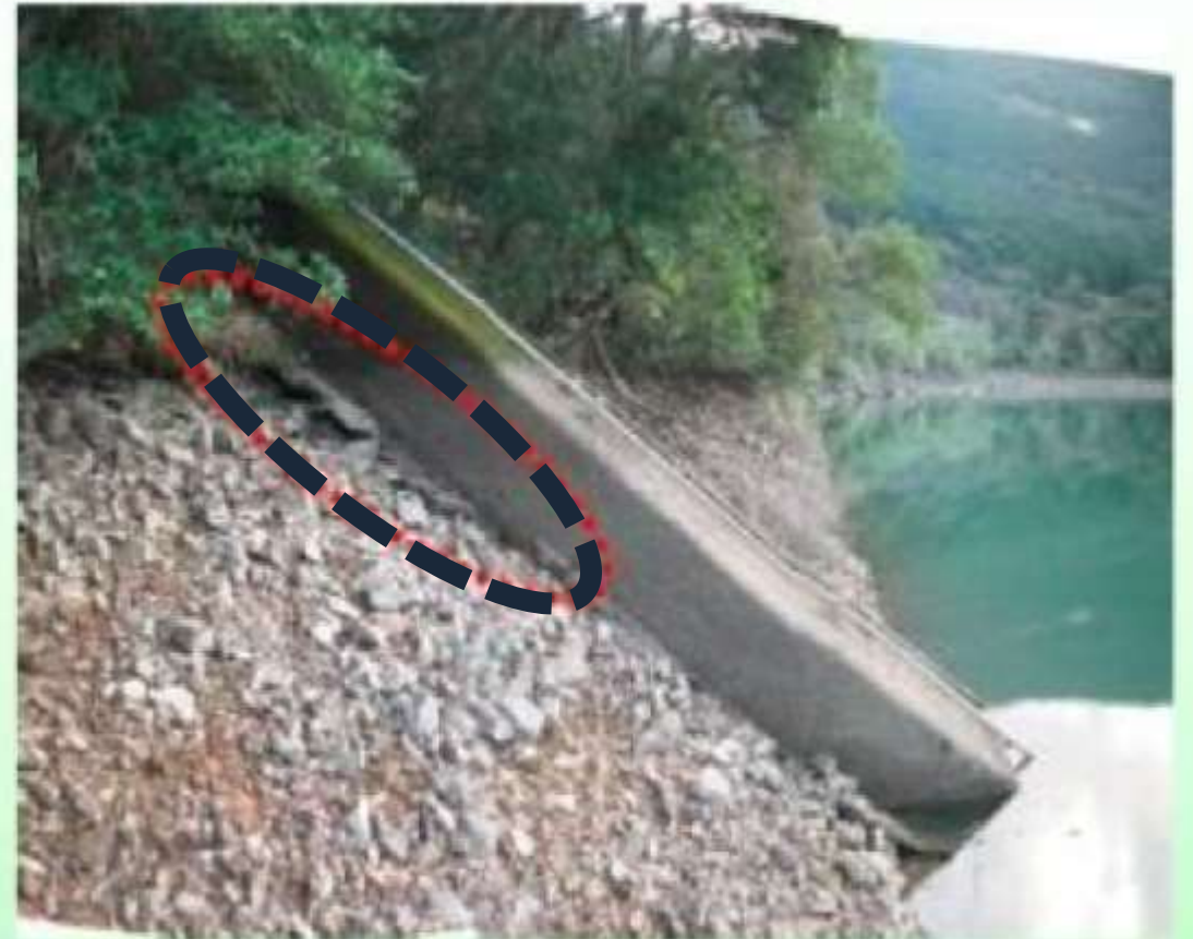
⑥斜樋底部の陥没
