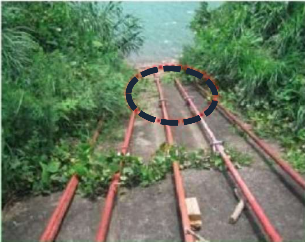
⑤斜樋の破損(スピンドル挫屈)
